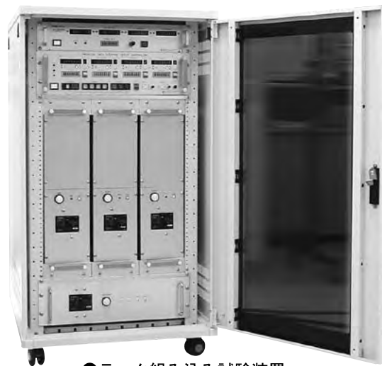
●ラック組み込み試験装置
