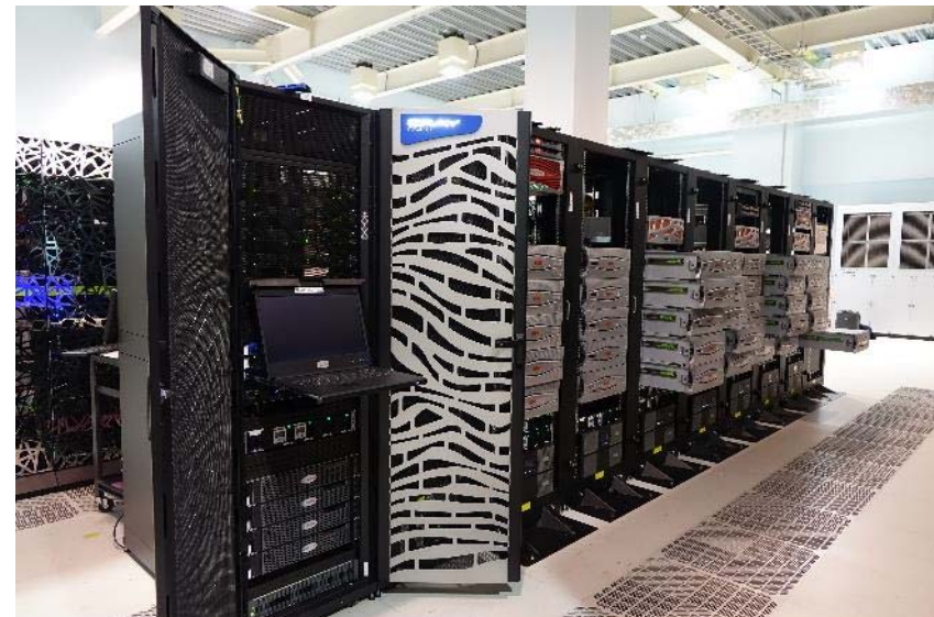
ラックで調整中の外部記憶装置とサーバ類(4/20)
