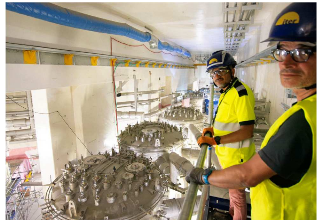
図7 トカマク建屋内に設置された5基の補助冷却ボックス。クライオラインとの接続が完了し、試験が開始されている（写真：ITER機構提供）。
