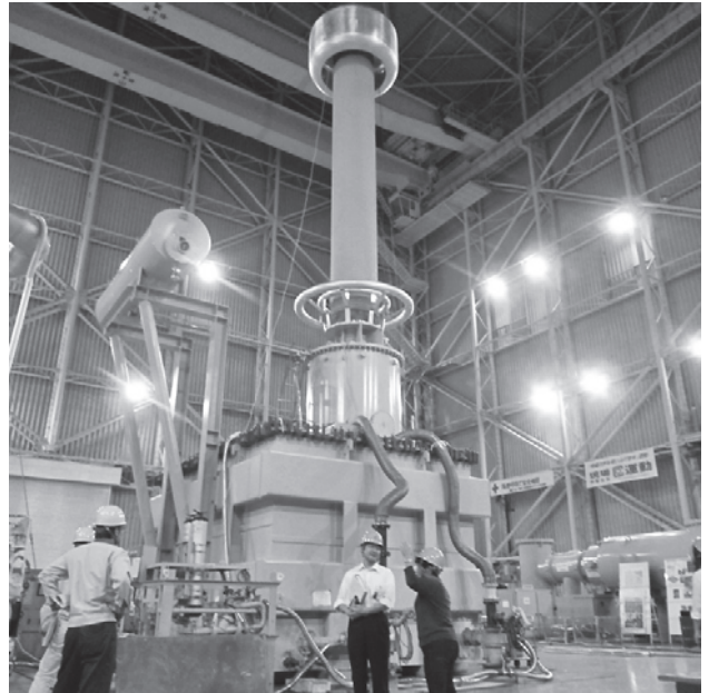
図3 開発した絶縁変圧器(高さ 16 m).
