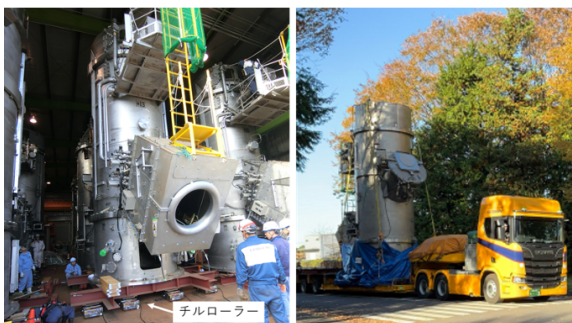
図3 保管場所から移動中の P-NBI タンクの様子。
