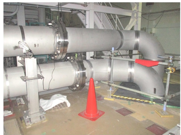
図 3 一次冷却水配管母管。
