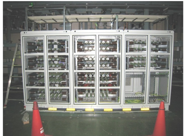
図 2 中点接地用抵抗器盤。
