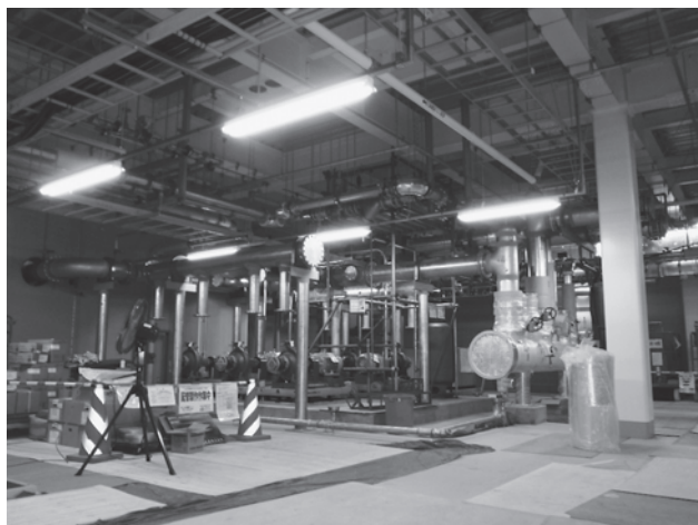
ポンプ、ヘッダがそろった冷水供給設備
