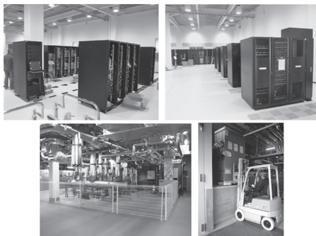
図2 計算機・遠隔実験棟の工事の状況。 計算機・遠隔実験棟2階計算機室へ据付けられたラック（左上）や無停電電源等（UPS、右上）、1階計算機補機室の冷水供給ヘッダ（右上）、コンピューターラックの搬送作業（右下）
