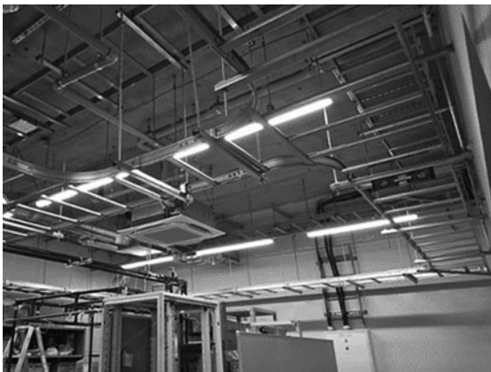
図 3 ケーブルラック。
