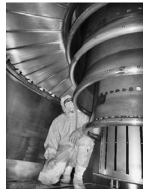
図10 HV ブッシング内部.
