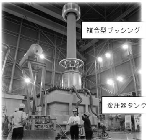
図 3 直流 1 MV 絶縁変圧器試作器。
