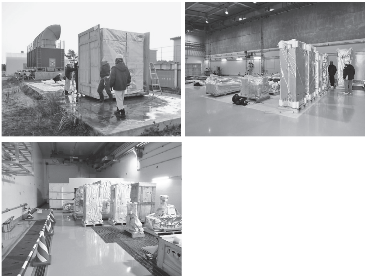
図3 開梱、搬送、内容物の確認の作業が行われている IFMIF/EVEDA 原型加速器の入射器(左上から、屋外の配電盤の開梱作業、高周波源・電源室で開梱された制御パネル等、加速器室に移設された入射器本体部品等。11月27日、いずれも国際核融合エネルギー研究センターにて。)
