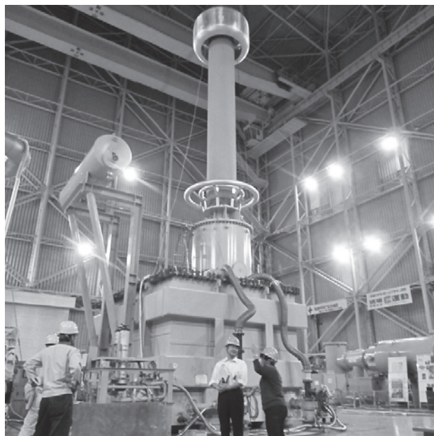
図3 開発した絶縁変圧器(高さ 16 m)。
