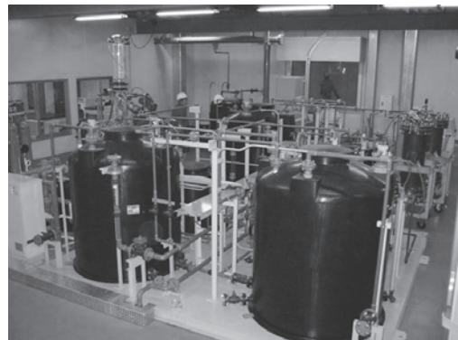
図7 海水リチウム回収プラント(塩酸タンク側から望む)。
