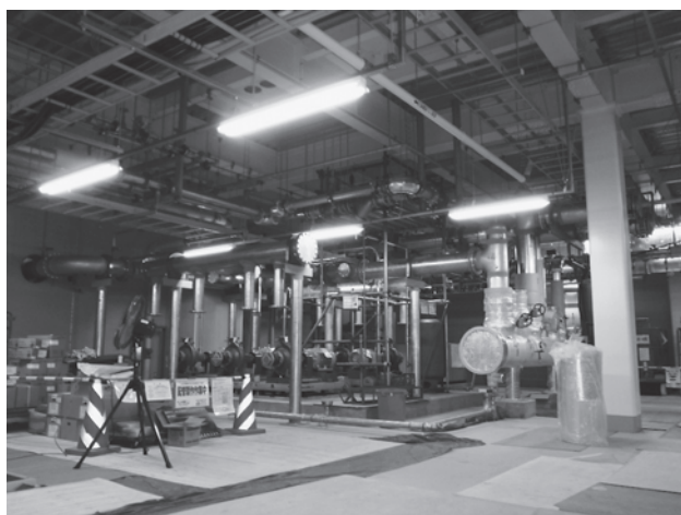
ポンプ、ヘッドがそろった冷水供給設備
