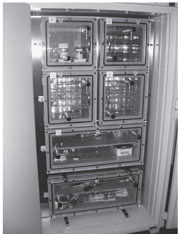
図2 トリチウムガス保管庫。
